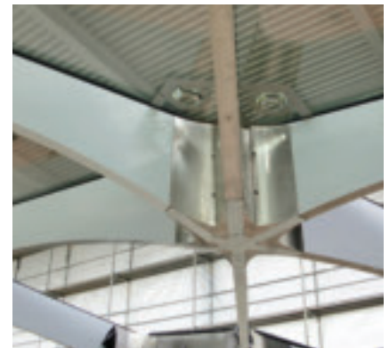
Bild 2: Knotenelement: Die Wölbung erzwingt eine sehr komplexe, dreidimensional verdrehte Geometrie der einzelnen Knotenelemente und der sie verbindenden Riegel
