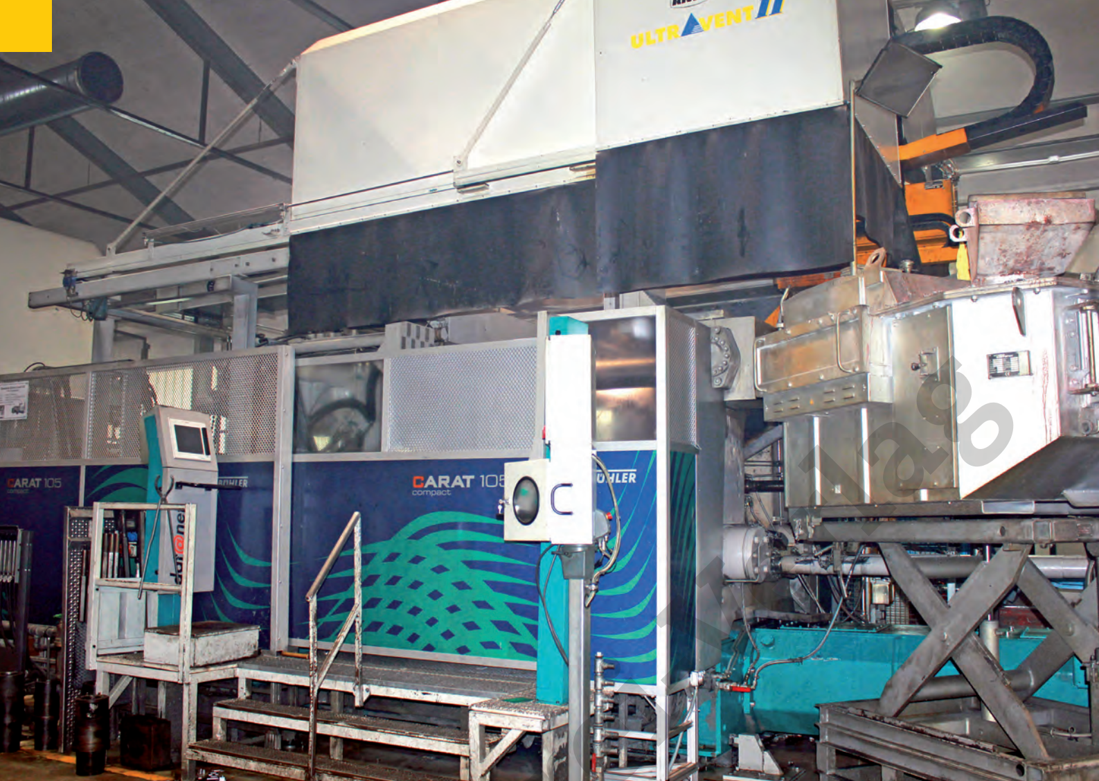
Herzstück dieser vollautomatischen Gießzelle ist eine moderne Carat-Druckgießmaschine
